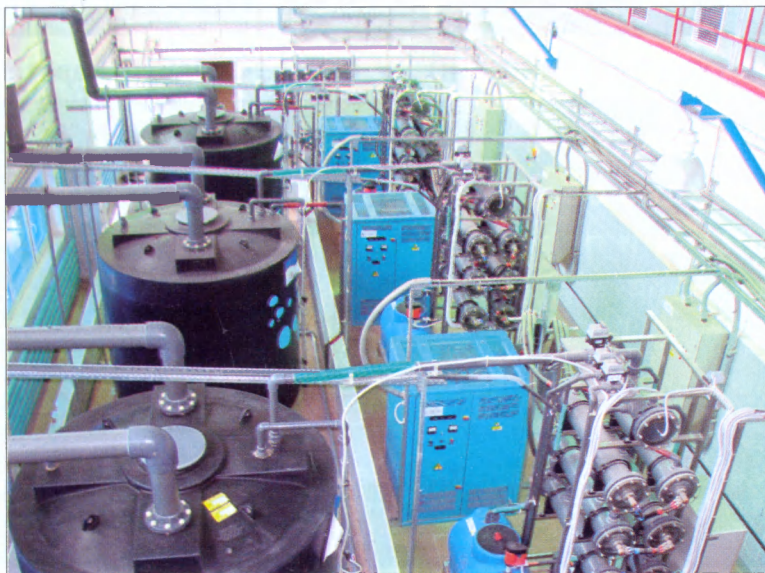
Рис. 2. Электролизные установки цеха по производству гипохлорита натрия
