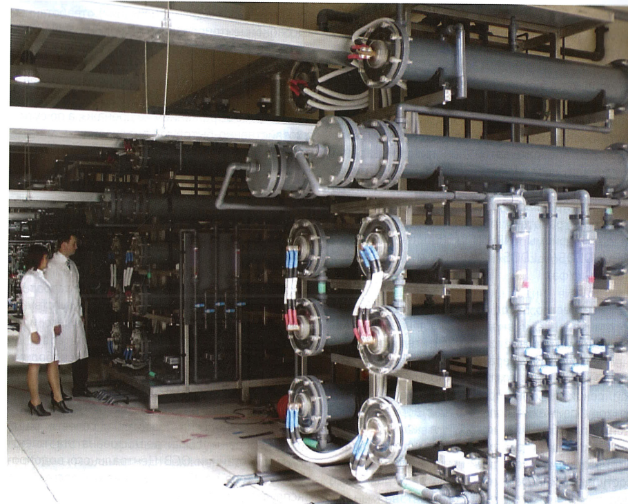
Рисунок 3 Электролизная станция на Александровских ОСВ с семью установками «Хлорэкс» производительностью 7 т/сут. по эквиваленту хлора для обеззараживания питьевой воды (г. Ростов-на-Дону).
