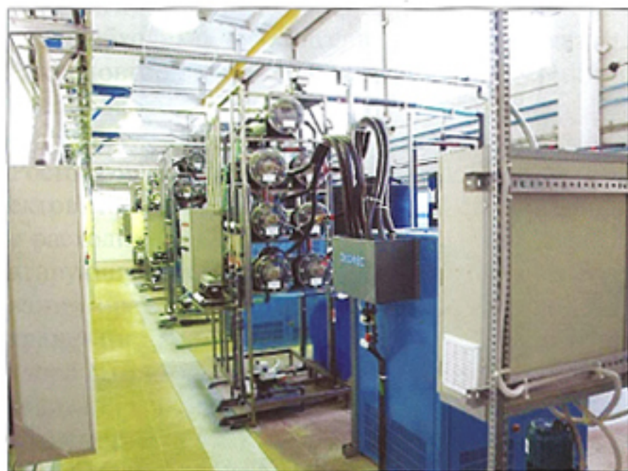
Рис. 2. Цех по производству гипохлорита натрия на Центральных очистных сооружениях водопровода г. Ростова-на-Дону
