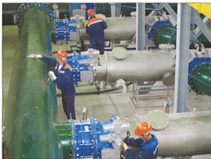
Рис. 3. Станция ультрафиолетового обеззараживания
