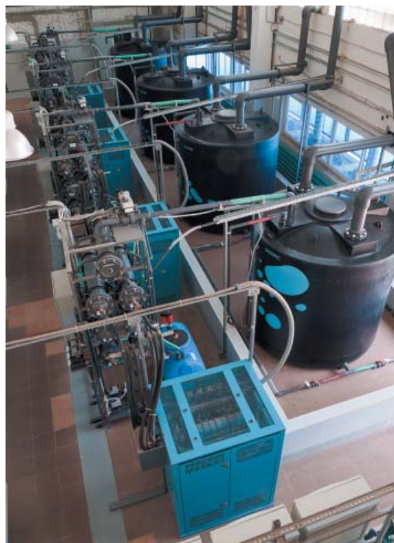
Рис. 1. Четыре электролизных установки «Хлорэфс» УГ-25МК-250 производительностью 250 кг/сут по активному хлору каждая для обеззараживания питьевой воды (2008 г.)
