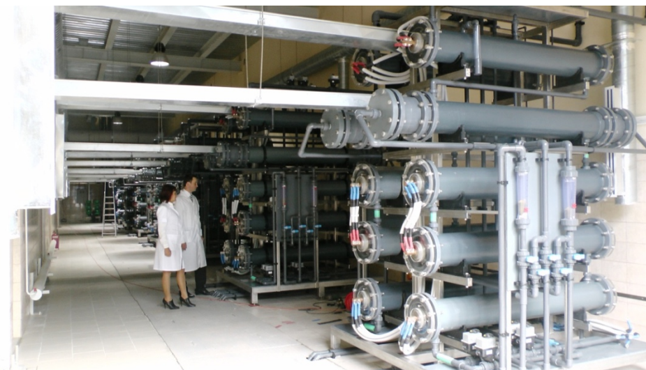
Рисунок 1. Электролизная станция на Александровских ОСВ с семью установками «ХЛОРЕФС» производительностью 7 т/сут по эквиваленту хлора для обеззараживания питьевой воды г. Ростова-на-Дону
